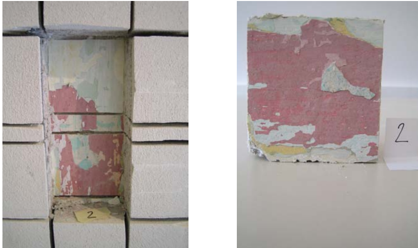
Abb. 43 Bruch innerhalb der Farbschichten
