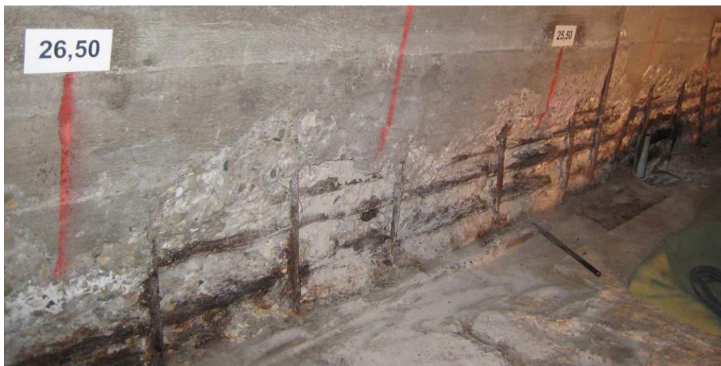
Abb. 30: Chloridschädigung an den Widerlagern einer Brücke (Kreuznach)
