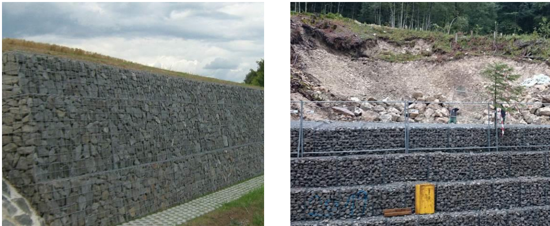
Abb. 11: Links – Fertiggestellte Gabionenwand zur Sicherung eines Geländesprunges (htb rochlitz); Rechts – Etagenweise Herstellung einer Gabionenwand (fmt)
