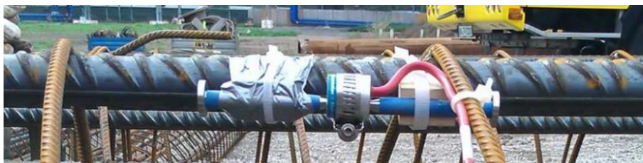
Abb. 120: Schwingsaitenaufnehmer appliziert an einen Bewehrungskorb (Garbers, Fischer, Cudmani, & Maitschke)
