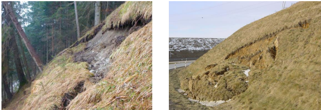
Abb. 45: Links – Abrisskante eines rutschgefährdeten Hanges (meinbezirk.at); Rechts – Geländeänderung als Versagensankündigung für einen Böschungsbruch
