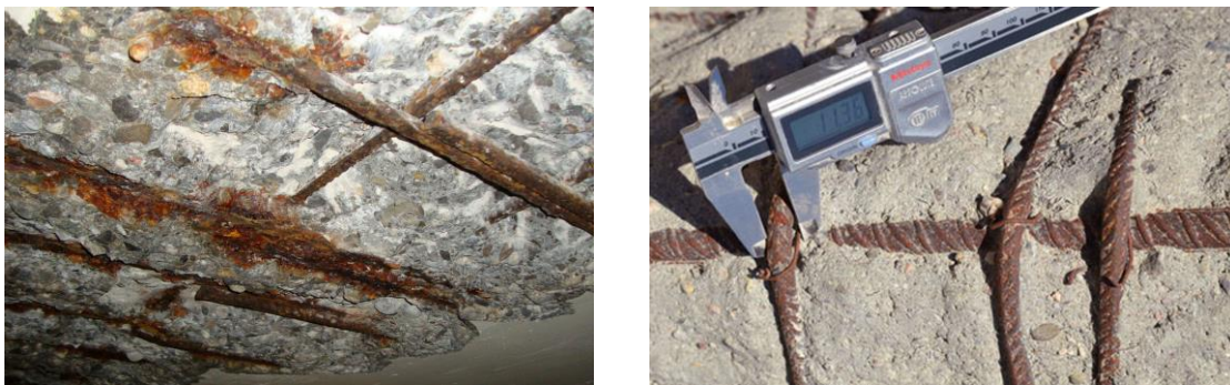
Abb. 67: Links – großflächige Abplatzungen eines Stahlbetonbauteiles; Rechts – Bestimmung des Stabstahldurchmessers (Weber, 2013)
