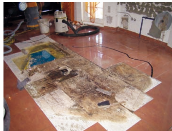
Abb. 1 Schimmelpilzbefall unter Fliesenbelag nach undichtem Zimmerbrunnen
