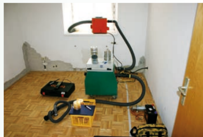
Abb. 7 Schimmelpilzbefall durch Putzentfernung saniert, Einblasöffnung in Raummitte und Sporensammler
