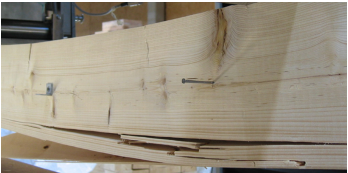
Abb. 5-19: HB, Splitterbruch des Zugfaserbereiches; 4 Punkt Biegebeanspruchung
