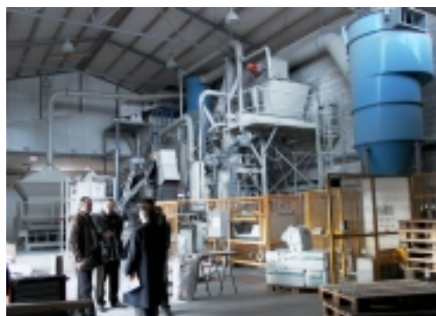
Abb. 12 Anlage zur Herstellung von Zellulosedämmung (im Hintergrund links der Shredder)
