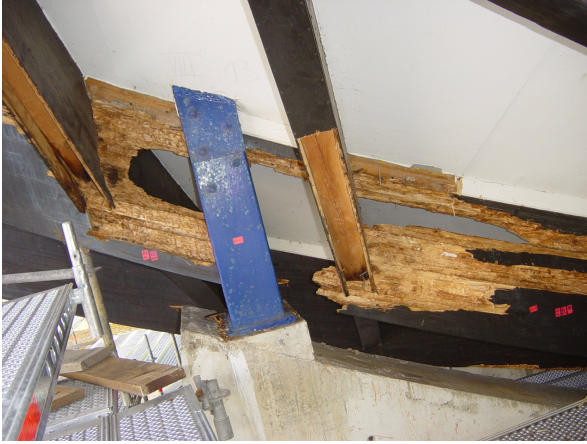
Abb. 10.1: Seitenansicht der ausgeräumten Faulstelle (Hörsaal 1, Rippe 13) (Foto: Finnforest Merk)
