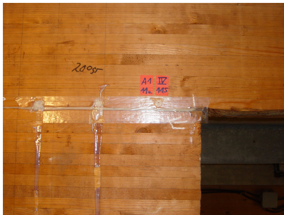
Abb. 3.4: breiterer verpresster Riss nach der Verpressung (Foto: Finnforest Merk)
