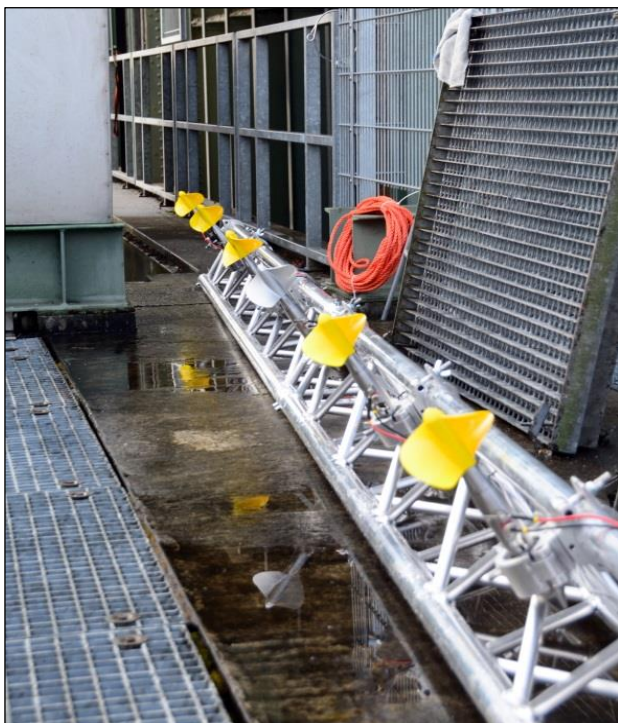
KW Meitingen / Lechkanal: P= 3*4 MW
