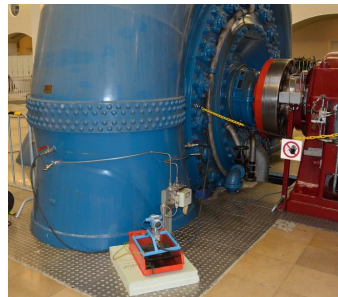
Indexmessung: Kraftwerk Reisach Francis mit 34 MW
