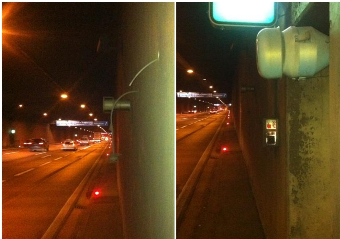
Abbildung 7: Messanordnung tunnelseitig, an der Rückwand zum Messraum. Im rechten Bild der DIGITEL PM 10 Vorabscheider für die Bestimmung von PM 10 und partikulärer Inhaltstoffe (Schwermetalle, PAH). Im linken Bild die gebündelten Ansaugleitungen für die Bestimmung der gasförmigen Komponenten und der Grobstaubabscheider für die kontinuierliche PM-Messung.
