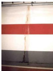
b) wasserführender Trennriss
