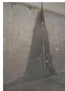
c) undichte Dehnfuge
